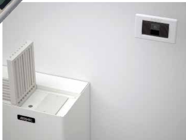
TL3-Empfänger an der Wand montiert
